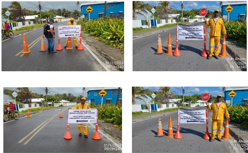
Ilustración 9. Personal de mantenimiento rutinario controlador del tráfico y direccionado a vías alternas Tom Hooker y Sound Bay Road.
